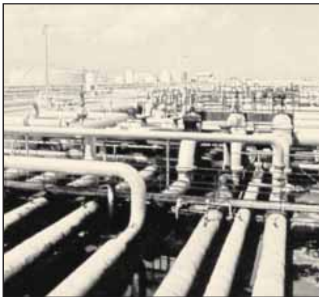
Fig. 5-27. En los centros de operaciones petroleras, el recibo y despacho de gas natural crudo, despojado y/o tratado se hace utilizando redes de tuberías de determinadas especificaciones.
