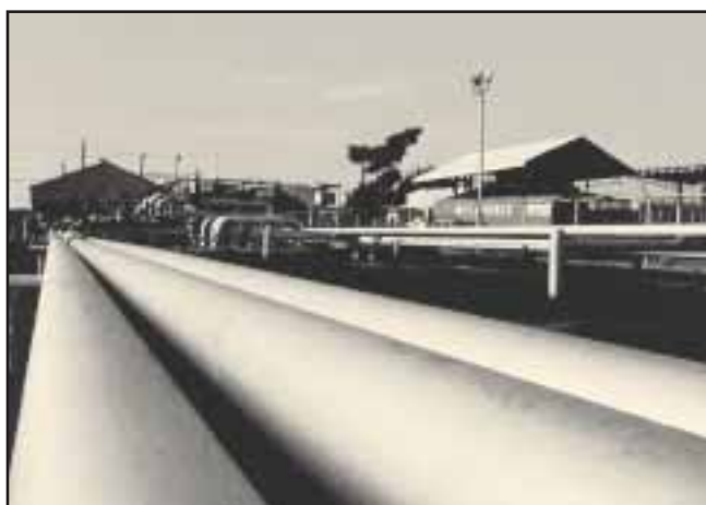
Fig. 5-28. Los gasductos de gran diámetro y de muchos kilómetros de longitud que transportan diariamente enormes volúmenes de gas requieren de estaciones de recompresión a lo largo del trayecto.
