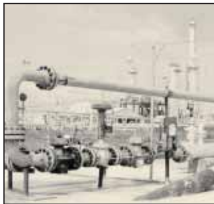
Fig. 5-2. Instalaciones de control de flujo del gasducto Ulé-Amuay.
