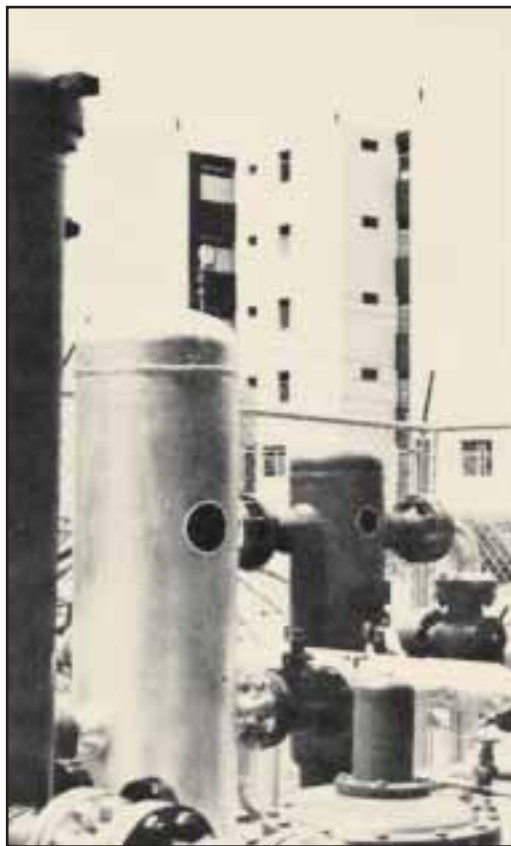
Fig. 5-29. Instalaciones para distribución de gas doméstico en La Haciendita, Cagua, estado Aragua.
