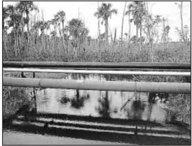
Fig. 8-9. Para cruzar ríos angostos se opta por suspender la tubería por razones económicas, para proteger su integridad física y por conveniencia operacional.
