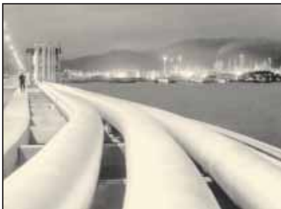
Fig. 8-8. Los ductos transportan diariamente grandes volúmenes de hidrocarburos, crudos y/o derivados, a las terminales para despacharlos luego al mercado nacional o hacia el exterior.
