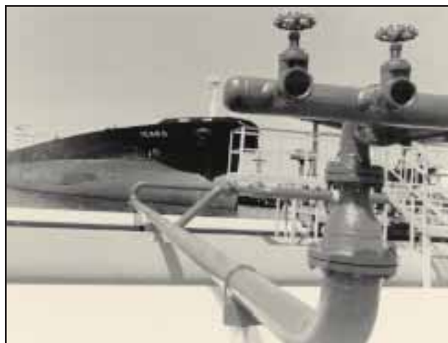
Fig. 10-15. Tanqueros de otras empresas cargan crudos y/o productos en las terminales venezolanas.
